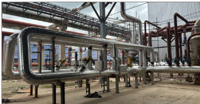
2 bộ PRDSH, 4 trạm khử quá nhiệt Sản xuất điện dựa trên giấy và bột giấy và sinh khối, Thái Lan
