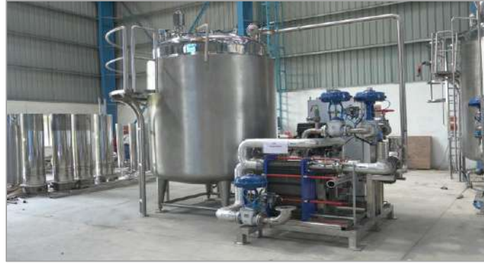
Hệ thống nước tinh khiết 6.000 lít mỗi giờ, Công ty dược phẩm Nigeria
