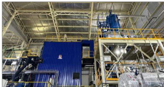
6 Nồi hơi TPH UPRG (nhiên liệu - dăm gỗ) Chế biến nông sản và thực phẩm Thái Lan
