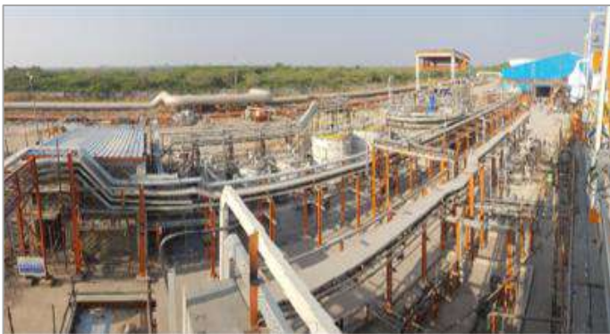
6.4 Nhà máy khử mặn nước biển MLD Công ty xăng dầu Ấn Độ
