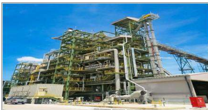
48 TPH chất thải thành lò hơi năng lượng Công ty kỹ thuật và xây dựng Thái Lan
