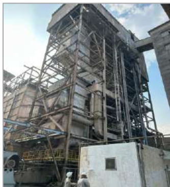
Lò hơi đốt than 65 TPH Nhà sản xuất hóa chất Việt Nam
