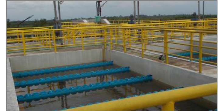
Nhà máy khử mặn nước biển 442 m 3 / giờ Chuyên ngành dầu cọ Indonesia
