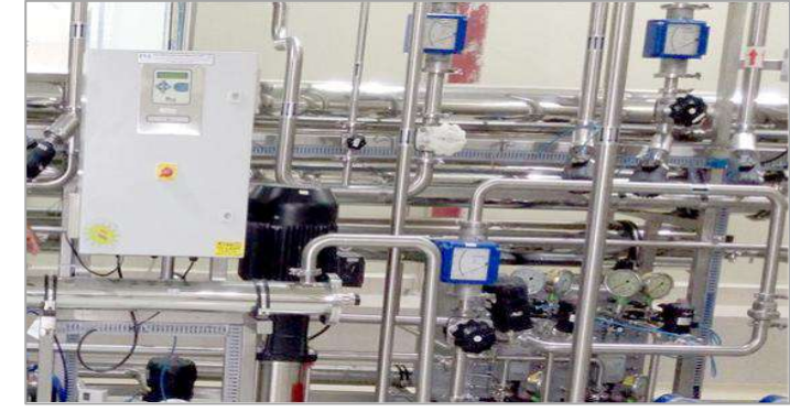
20.000 lít/giờ hệ thống tiện ích sạch và bình xử lý Chuyên ngành dược phẩm, Ả Rập Xê Út
