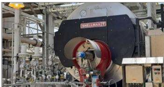
Nồi hơi đốt khí 30 TPH Công ty xăng dầu Ả Rập Xê Út
