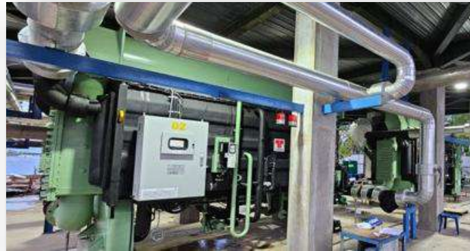
Máy làm lạnh hấp thụ hơi nước hiệu ứng kép 3 X 500 TR Máy chế biến dừa, Indonesia
