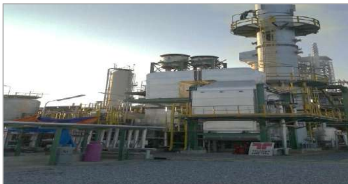
Lò hơi đốt than 30 TPH Khai thác mỏ Việt Nam
