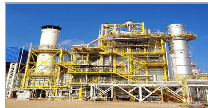
Máy xông hơi thu hồi nhiệt 132 TPH (HRSG) Công ty cơ sở hạ tầng và tiện ích khí đốt, Malaysia
